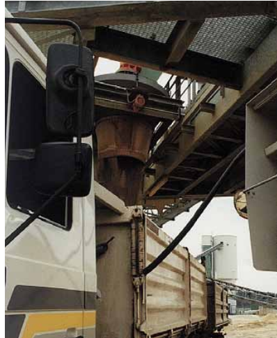
Tellermischer integriert in LKW-Verladung
